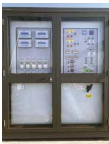
11. Il quadro elettrico per una gestione manuale del sistema e per le operazioni di manutenzione 11. The electrical panel for manual management of the system and for maintenance operations
