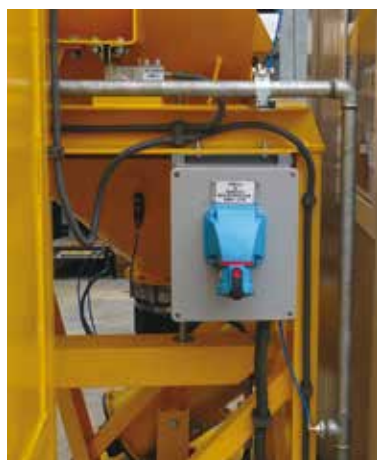
9. Il vagone mixer è equipaggiato con prese di servizio multitemperatura con correnti nominali fino a 32 A in grado di accogliere sia spine trifasi con neutro che monofasi
